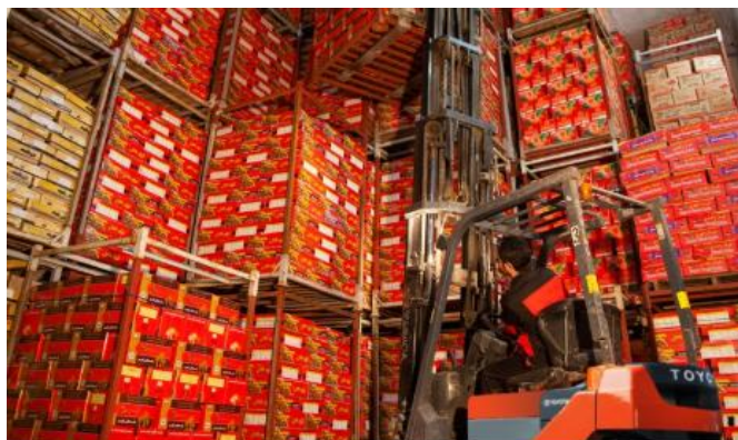
سردخانه سزدشت (اسلامشهر - تهران) - عیب یابی کمپرسور اسکرو آمونیاک - عیب یابی ژنراتور برق COMMINS
