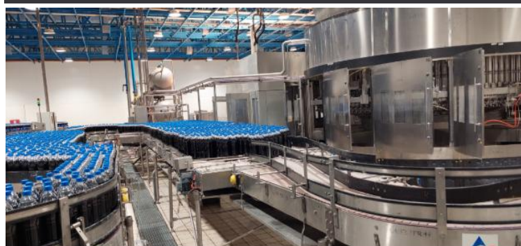
نیسان شرق (شهرک صنعتی توس - مشهد) - نصب و راه اندازی خط تولید SIDEL
